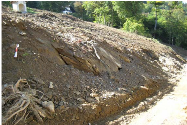
Verwitterter Fels bereits knapp unter der Oberfläche. Mehrkosten bei Aushub.
