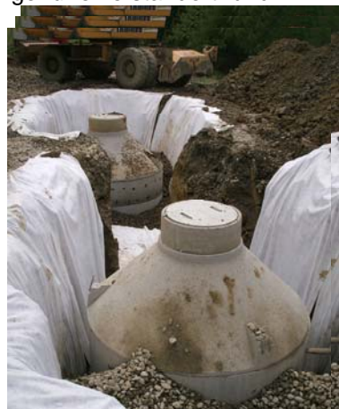
Versickerungsanlage mit in großem Kieskörper eingestellten Schächten
