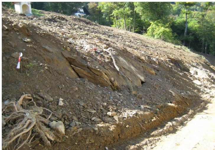
Verwitterter Fels bereits knapp unter der Oberfläche. Mehrkosten bei Aushub.
